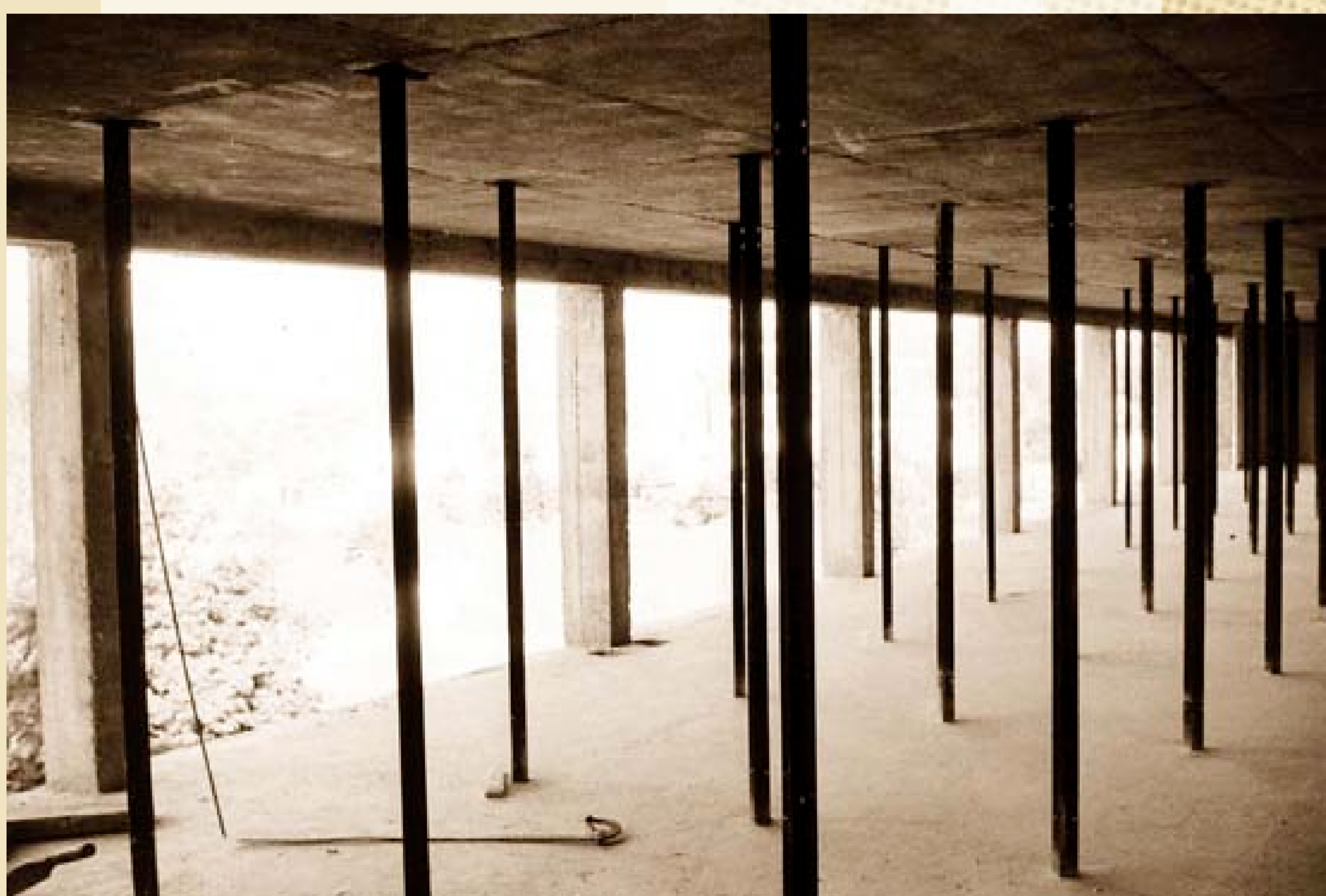
Vue des poteaux porteurs « Strafor Sneed » sur lesquels seront installés les rayonnages destinés à accueillir les archives.
